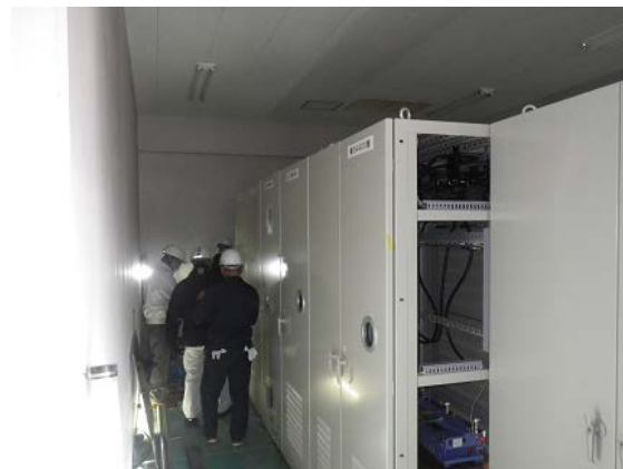
高圧受電盤納入検査②(R2. 12. 28)
