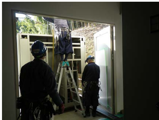
高圧受電盤納入③(R2. 12. 28)
