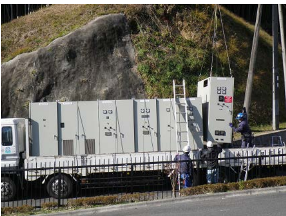
高圧受電盤納入②(R2. 12. 28)
