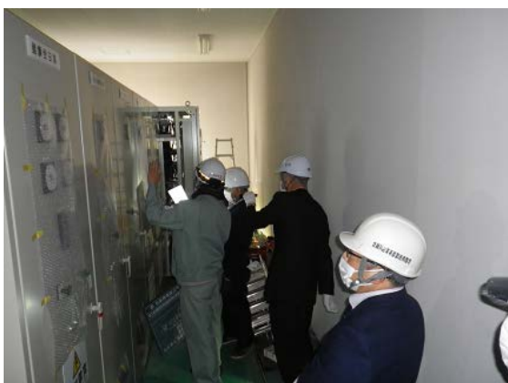
高圧受電盤納入検査①(R2. 12. 28)
