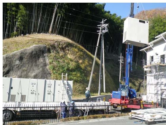
高圧受電盤納入①(R2. 12. 28)
