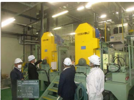
完成検査〔汚泥脱水機〕(R3. 3. 30)
