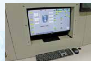
流動床制御システム
